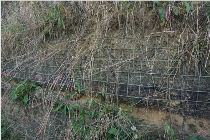
Gefahr durch Bewuchs; Wurzelschäden
