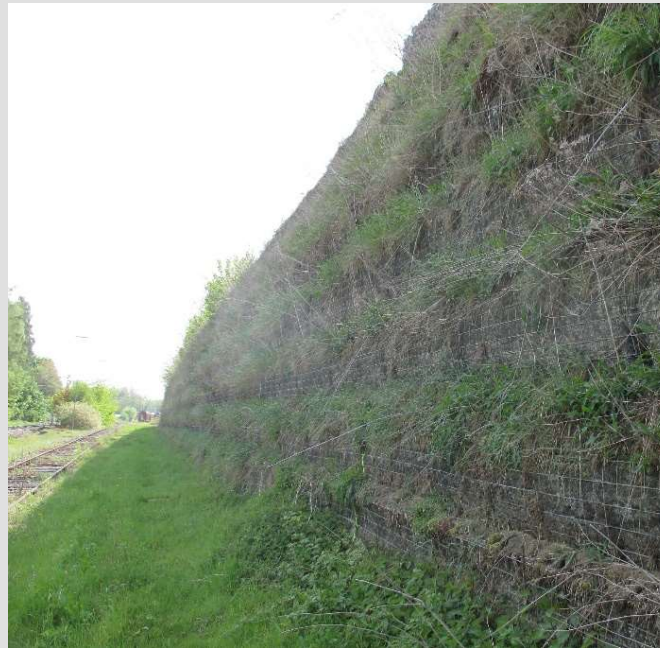
Drahtgitter teils gerissen
