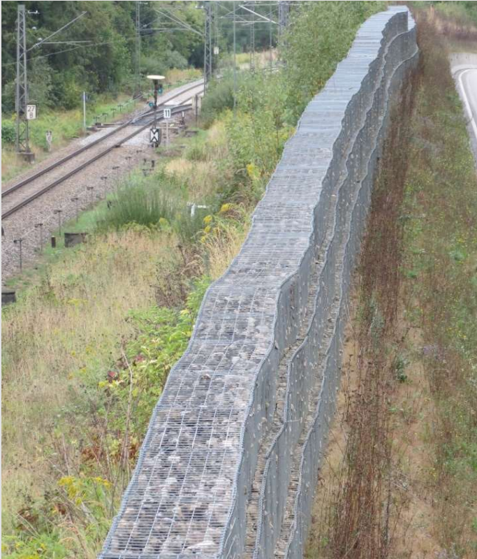
Deformation der Wandreihe im 2-stelligen Zentimeterbereich
