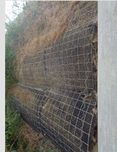
Erdverbundkonstruktion stark ausgebaucht
